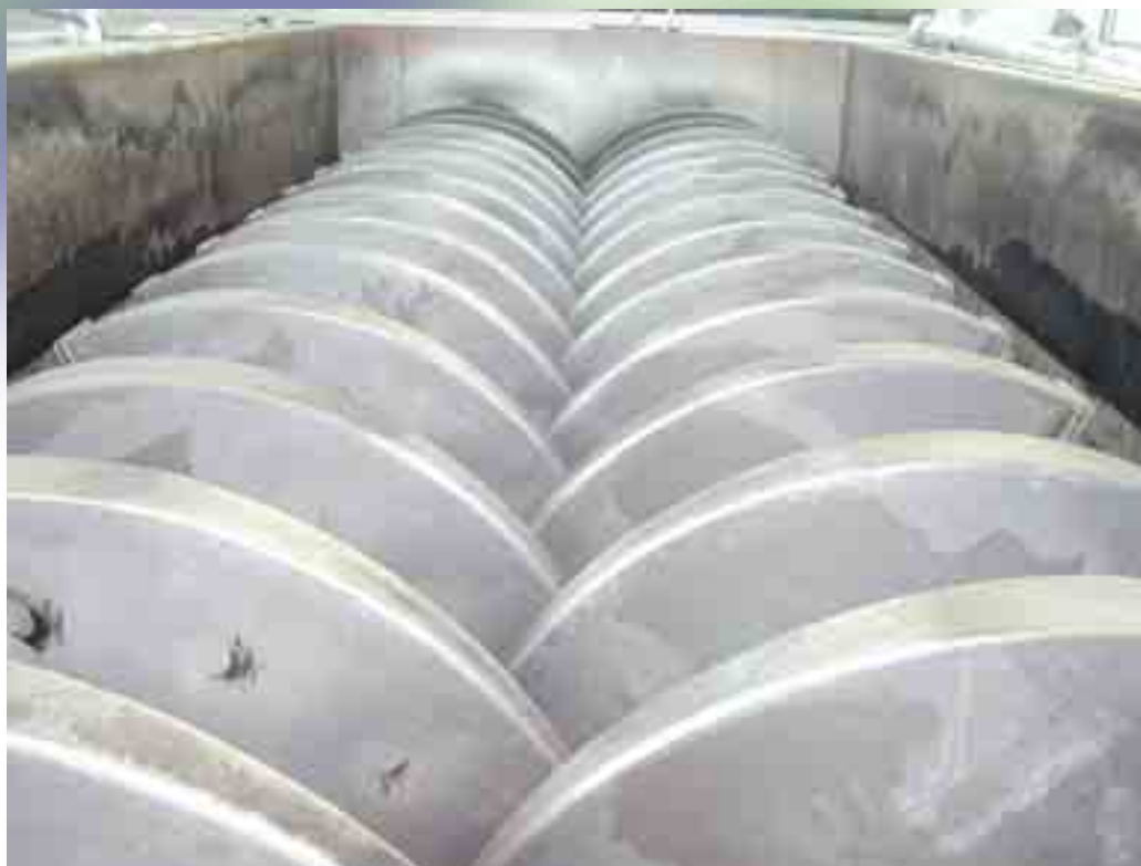
* Detalle del secado térmico de la EDAR
