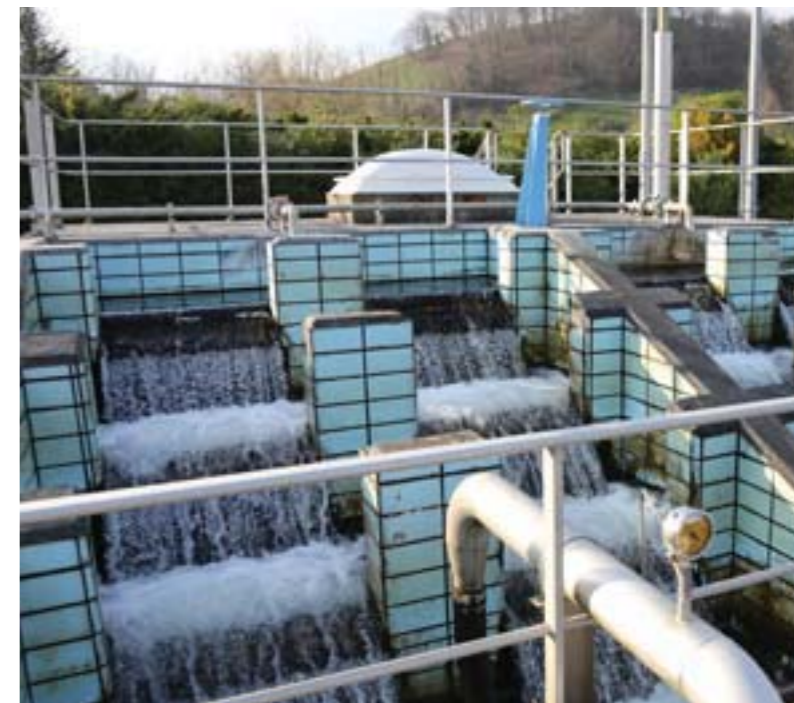
Saltos para aireación y oxidación natural del agua en la potabilizadora de Elordi
