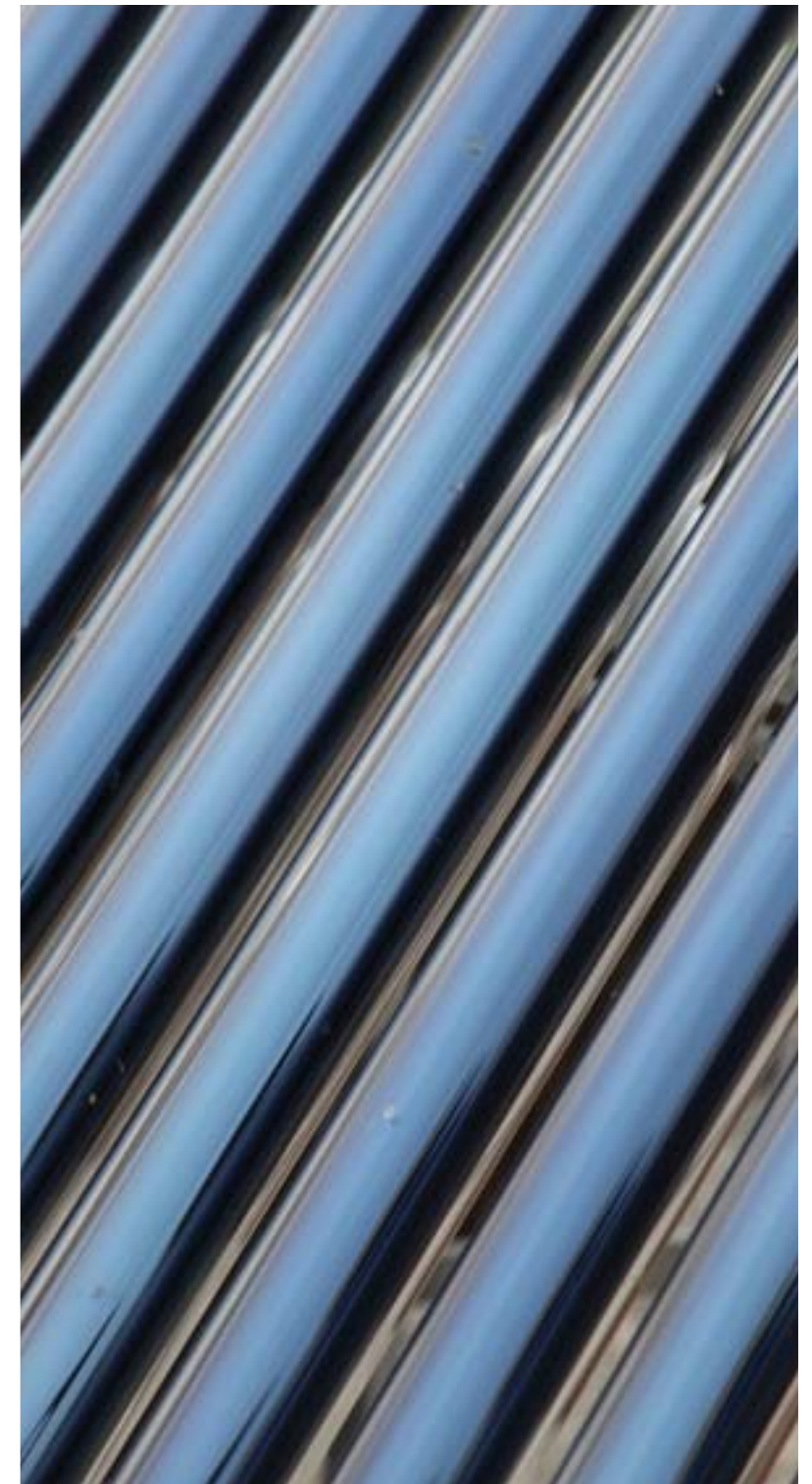
Detalle de tubos para producción de energía térmica-solar
