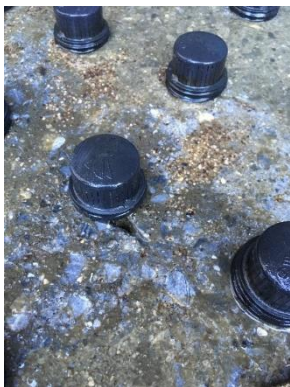
Detalle desgaste losa de soporte y acoplamiento de las boquillas
