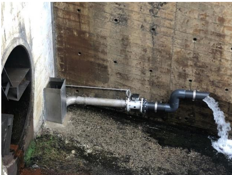
Caudalímetro de galería y ladera izquierda
