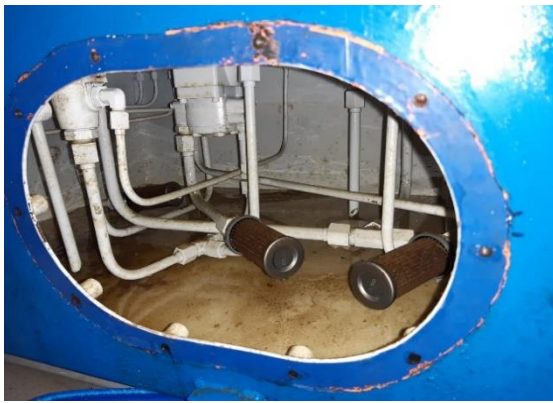
Detalle interior grupo hidráulico
