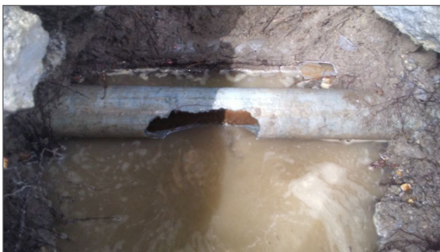
Fig. 3: Rotura en tubo de FC
